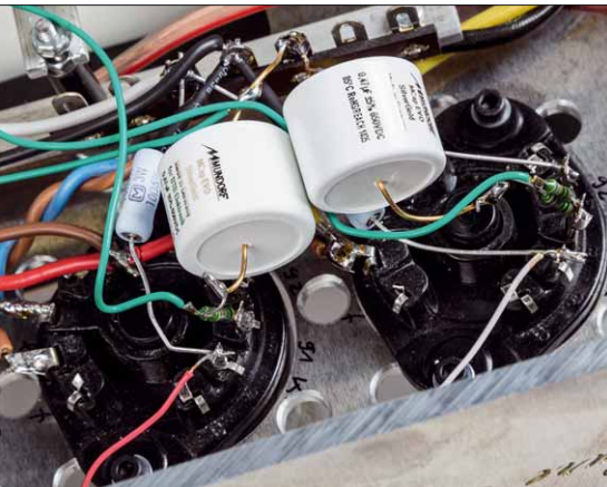
Die Verdrahtung der Leistungsröhren. Man beachte die dicht an den Fassungen montierten Widerstände
